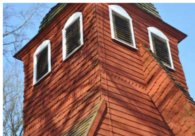
Gamla spån på sydsidans fasad.
