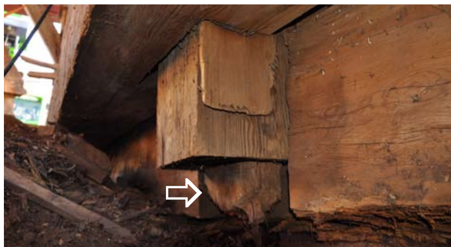
Här syns rester av tappan för originalsyllen.
