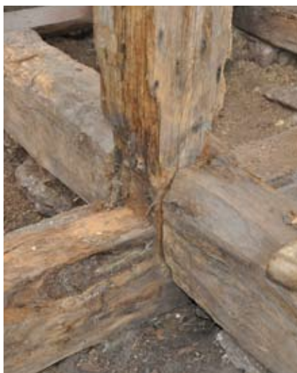
Möte mellan bocksyll, tvärsyll och mittstock. Rötskadat virke.
