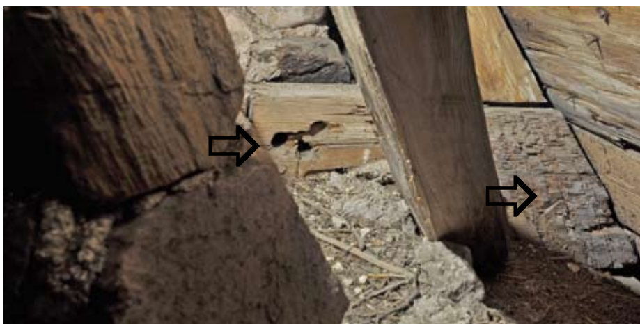
Den första takstolen i väster har tjänat som mall åt övriga 25. Därav skadorna efter borrhål och yxhugg.
