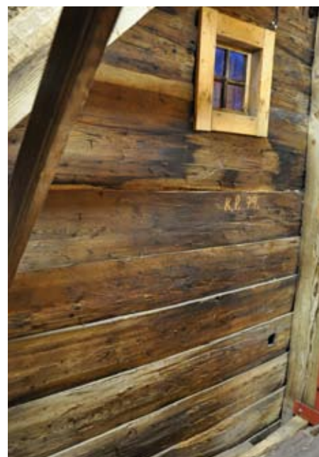
Panelens insida. Panelen är nu spånklädd på utsidan men var tidigare oklädd, så kallad panel på förvandring.
