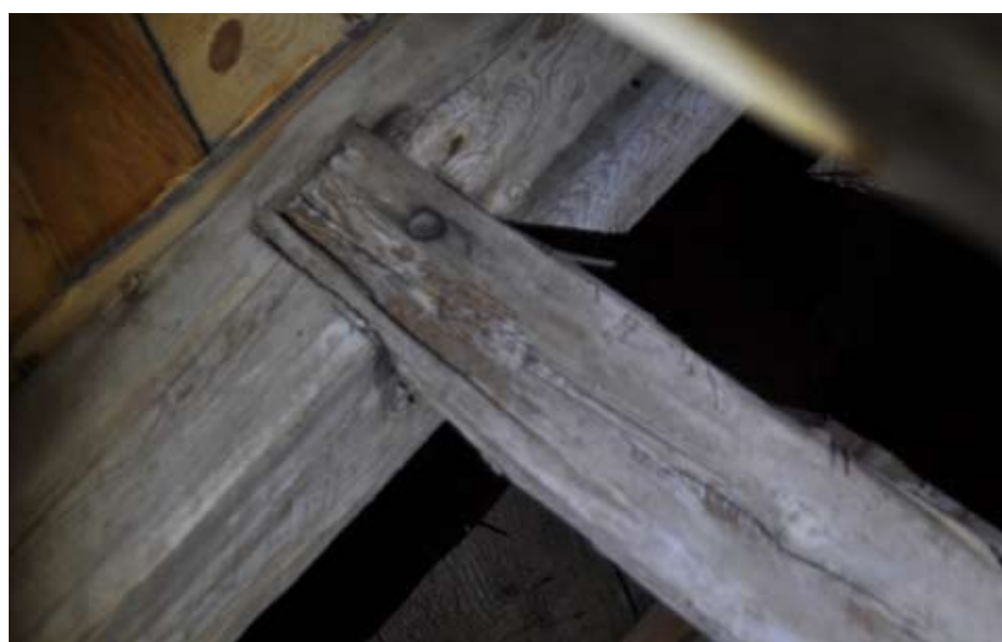
Husad knut mellan stötta och högben. Originalspik samt spår av vit färg.
