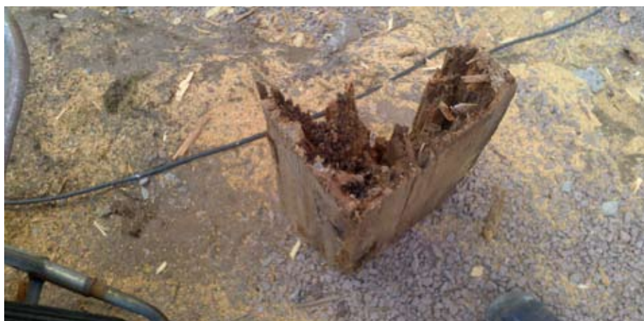
Mycket rötskadad bjälke.
