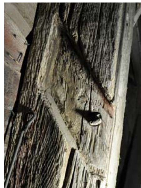
Bortplockad kryssträva visar knutens insida.
