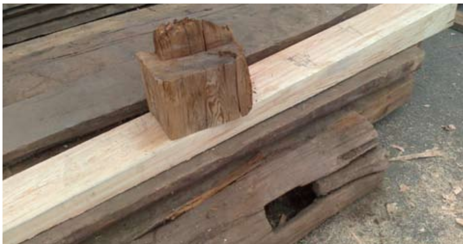
Bit av ursprunglig syll med tapp samt syll med tapphål.
